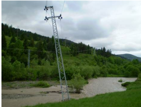
Vedenie vysokého napätia v oblasti Krompachy postihnuté povodňami
