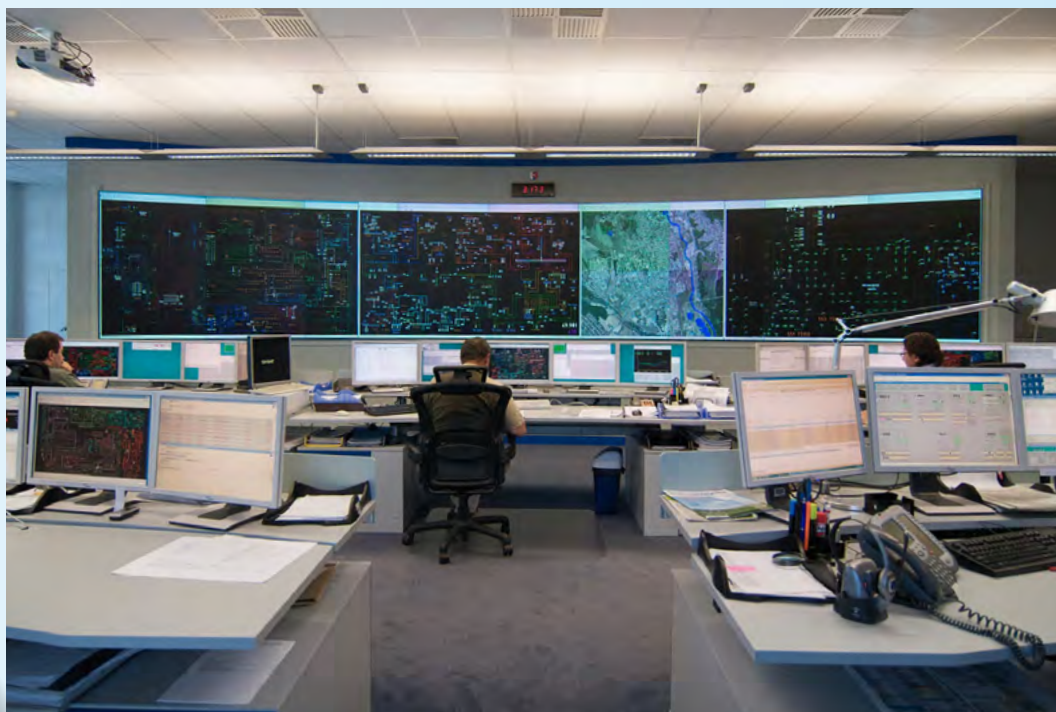
Dispečerské stredisko v plnej prevádzke
